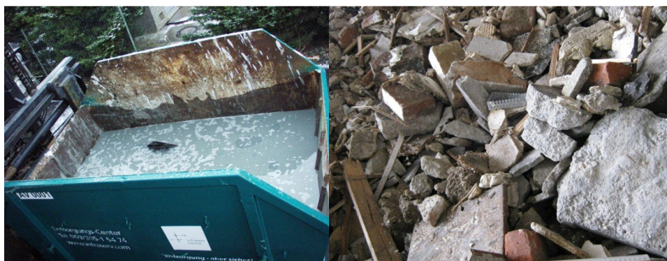
Folgen einer nicht abgeplanten Mulde
